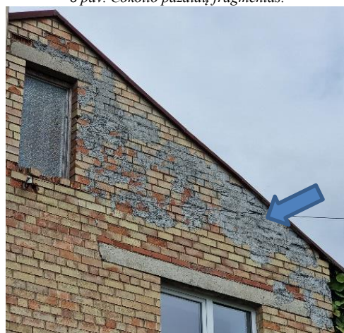
8 pav. Fasado pažeidimų fragmentas.
