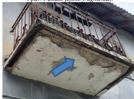
6 pav. Balkonų konstrukcijų būklės fragmentas.
