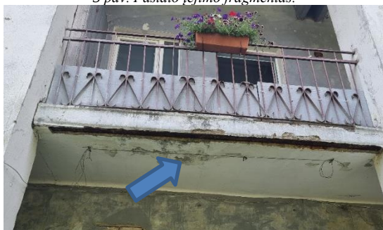
5 pav. Balkonų konstrukcijų būklės fragmentas.
