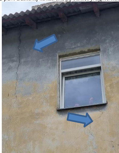
7 pav. Fasado pažeidimų fragmentas.
