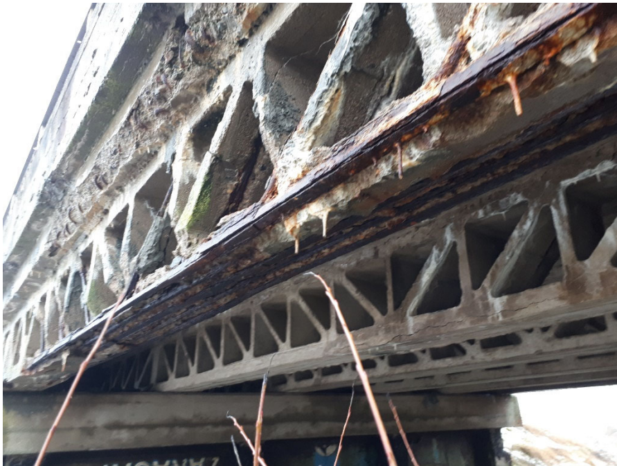
8 pav. Sijų apsauginis betono sluoksnis pažeistas, koroduoja laikančioji armatūra
