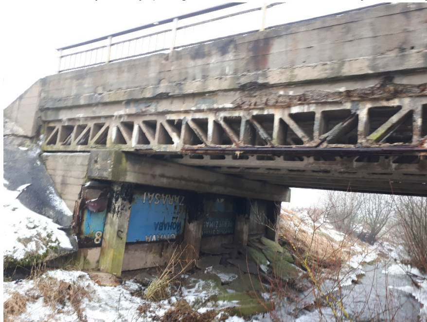
10 pav. Šlaitai ties krantinėmis atramomis netvarkingi
