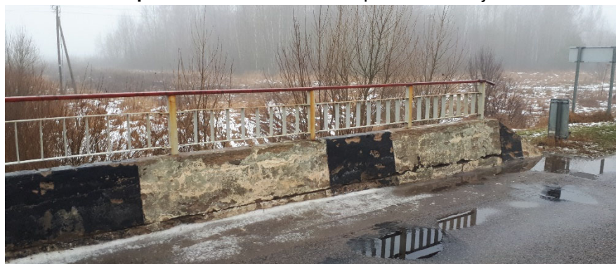
6 pav. Pažeistas g/b atitvarų apsauginis betono sluoksnis, koroduoja armatūra
