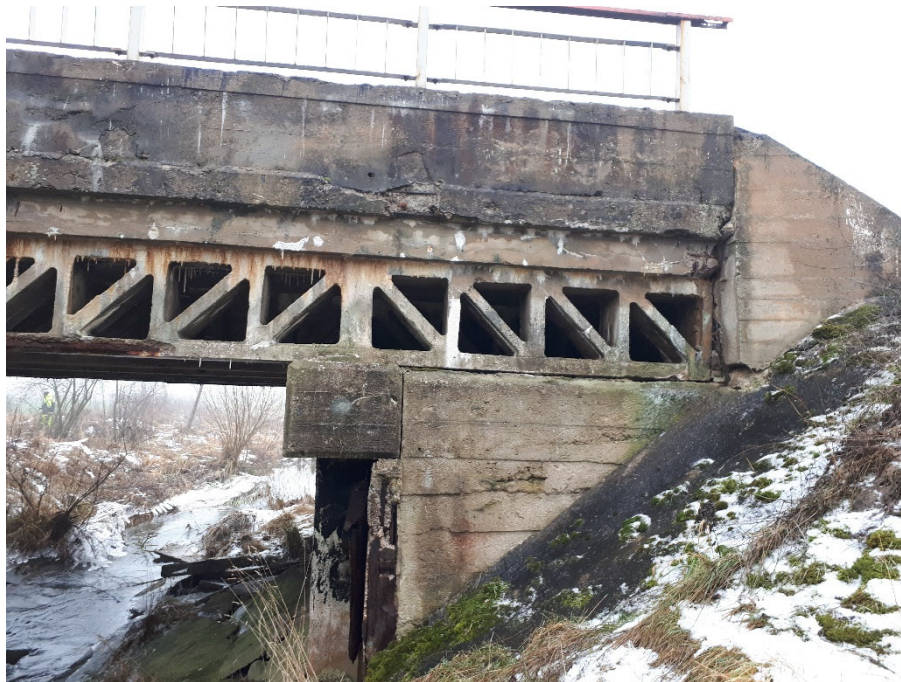
9 pav. Pažeistas krantinių atramų apsauginis betono sluoksnis, koroduoja laikančioji armatūra
