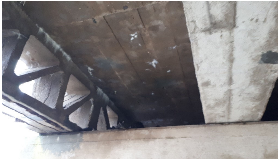
7 pav. Pažeistas hidroizoliacijos sluoksnis, vanduo skverbiasi per perdangos konstrukcijas
