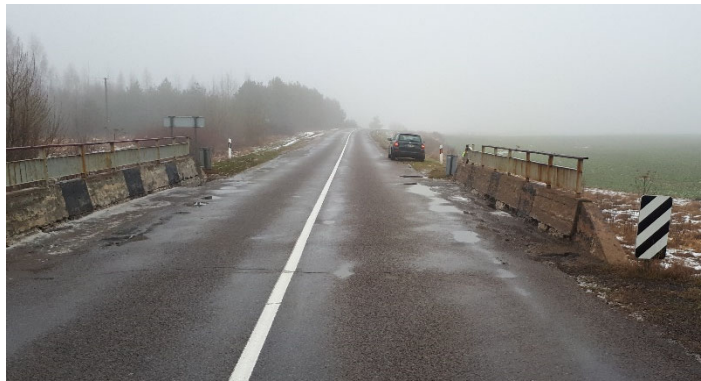
4 pav. Nėra vandens nuvedimo sistemos, susidaro balos
