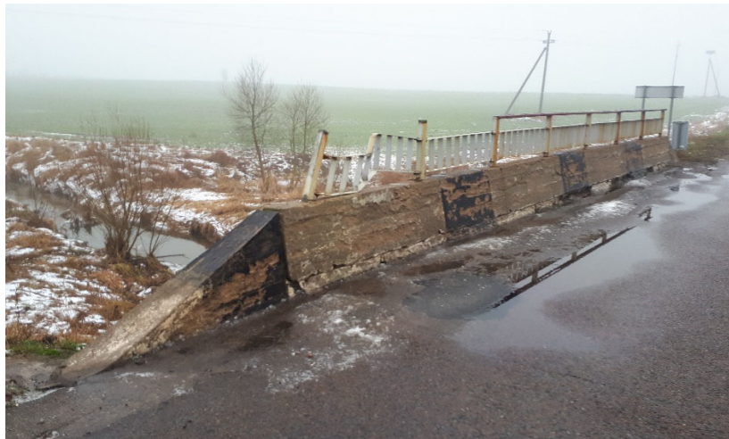
5 pav. Metaliniai tilto turėklai pažeisti korozijos
